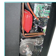
Ekspanzijska posuda, ventilator za odvod dimnih plinova
